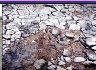
路床土の支持力低下が大きい場合に発生する亀裂
