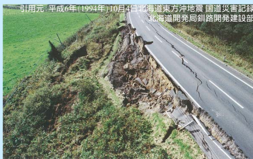
引用元:平成6年(1994年)10月4日北海道東方沖地震 国道災害記録 北海道開発局釧路開発建設部 1994年北海道東方沖地震による道路盛土の被害
