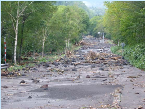
国道453号(支笏湖):平成26年9月の大雨により路面を覆う巨礫等。
