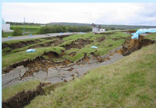
2003年十勝沖地震による河川堤防の被害。なお1993年釧路沖地震で被災した堤防で、強化復旧が行われた堤防は、この地震で被害は生じなかった。
