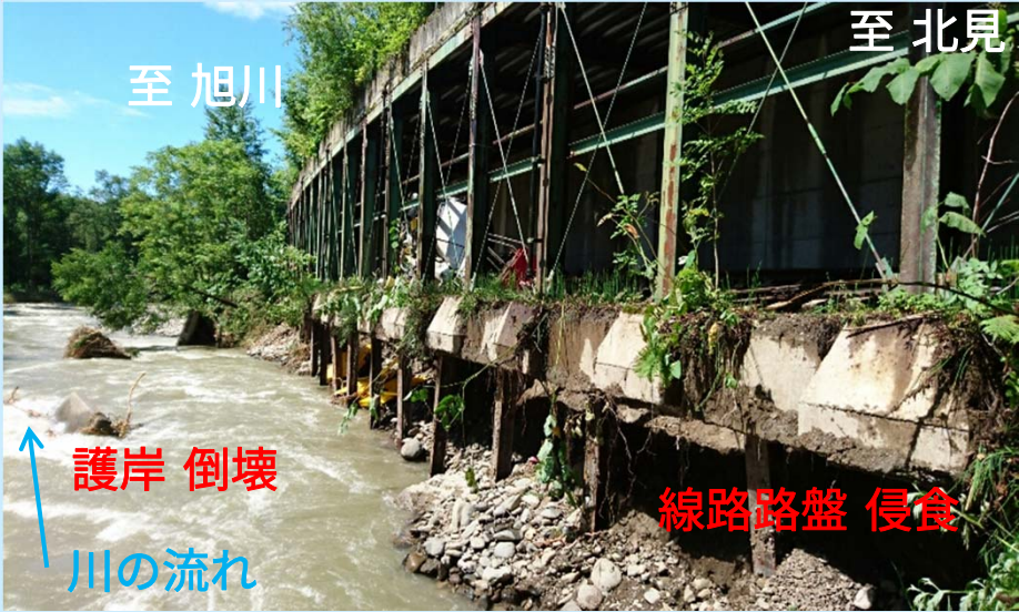
【線路外側から見た線路下部の路盤流出の状況】
