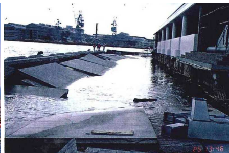
写真-3 埠頭南岸岸壁の被害状況
