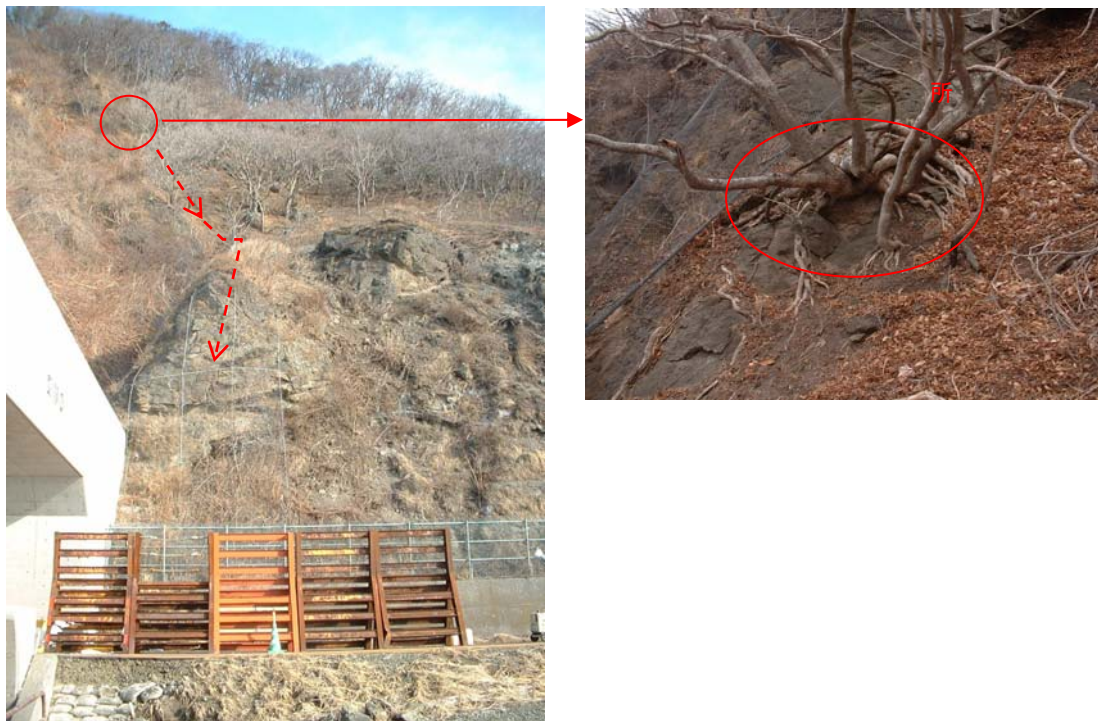
写真 3-10 強風による樹木の根部からの落石例（広尾町）
