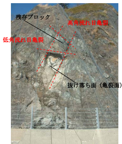
写真 3-2 高角度流れ盤亀裂の崩壊事例（えりも町）
