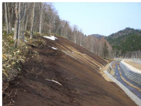
写真 3-6 同上 流出状況
