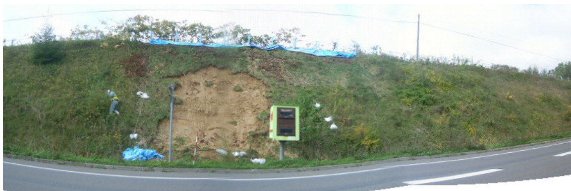
写真 3-9 法面上部が牧草地の崩壊例（幕別町）
