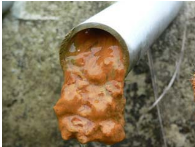
写真 3-16 排水ボーリングの錆びによる目詰まり (農林水産省資源化資料より)
