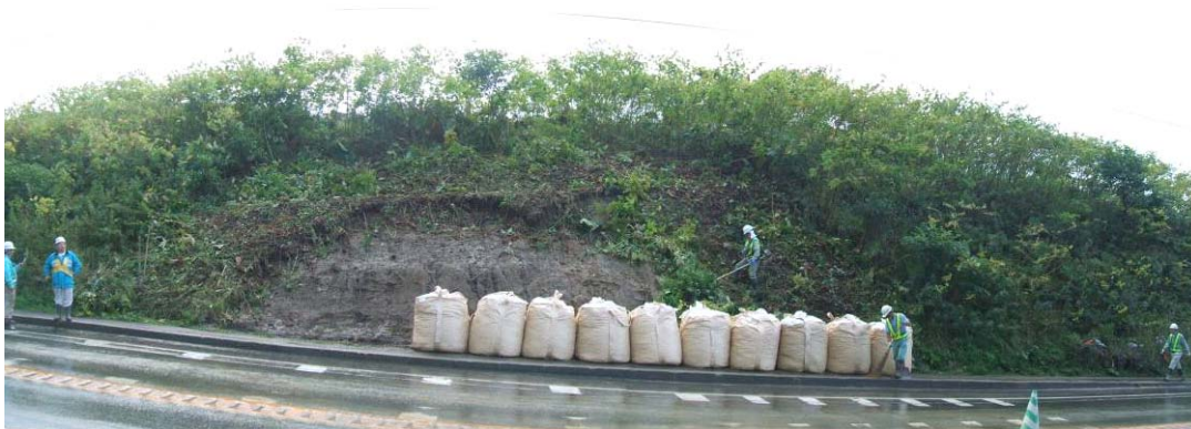
写真 3-10 法面上部が牧草地の崩壊例（浦河町）
