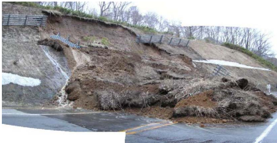
写真 3-1 集水斜面の崩壊例（石狩市）
