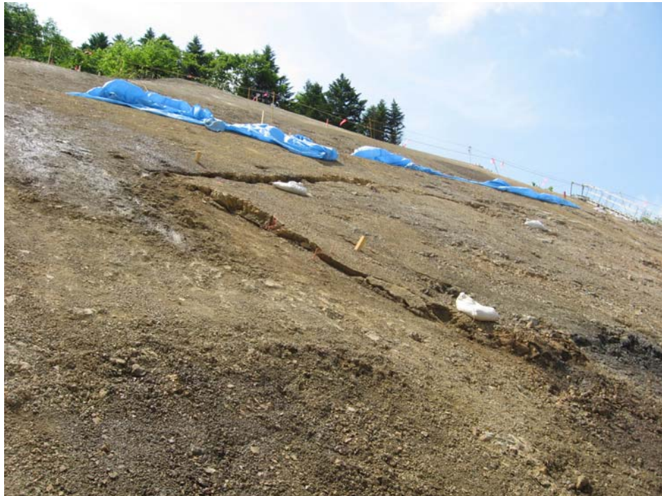
写真 2-4 施工中に発生した法面の変状事例（道央）
