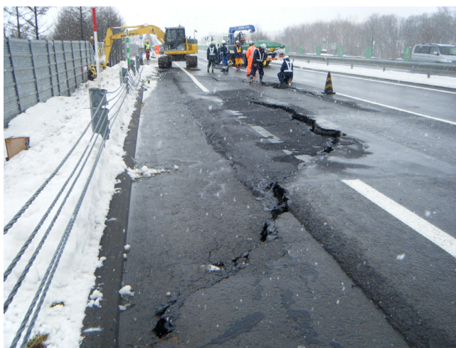
写真 4-1 通行止直後の路面状況
