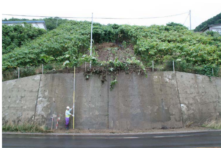
写真 3-2 過去の崩壊履歴箇所の崩壊例（岩内町）
