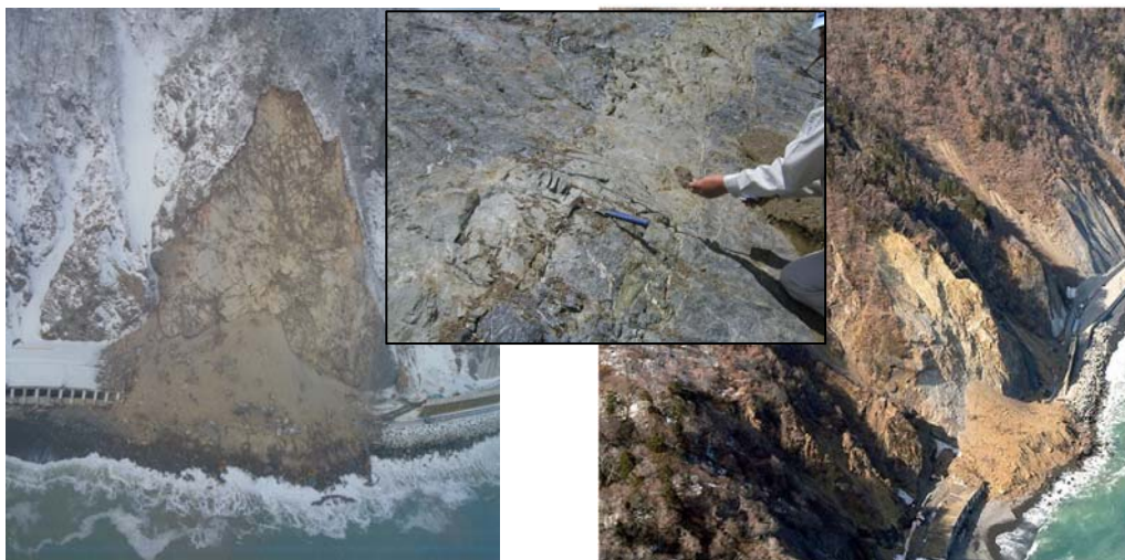
写真 3-4 白色鉍物脈の介在を要因とする岩盤崩壊（えりも町）
