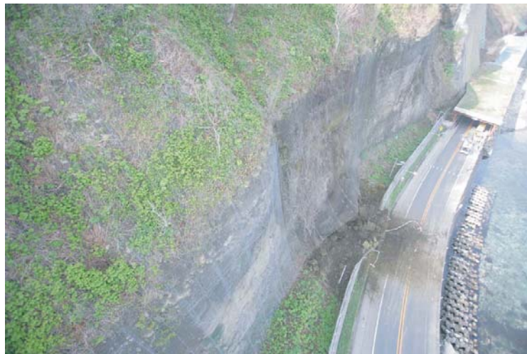
写真 1-1 急崖斜面における岩盤崩壊の発生例（小樽市）
