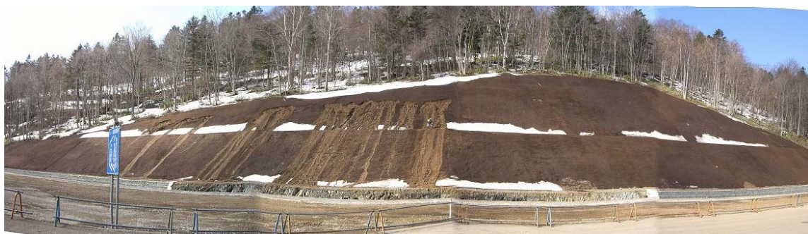
写真 3-5 切土された集水斜面の崩壊例（北見市）
