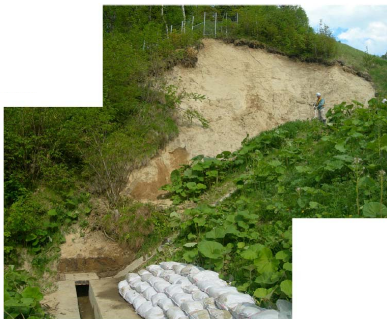
写真 2-3 新規路線の崩壊例（遠軽町）
