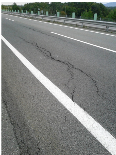
写真 3-1 H25 年 7 月の路面状況
