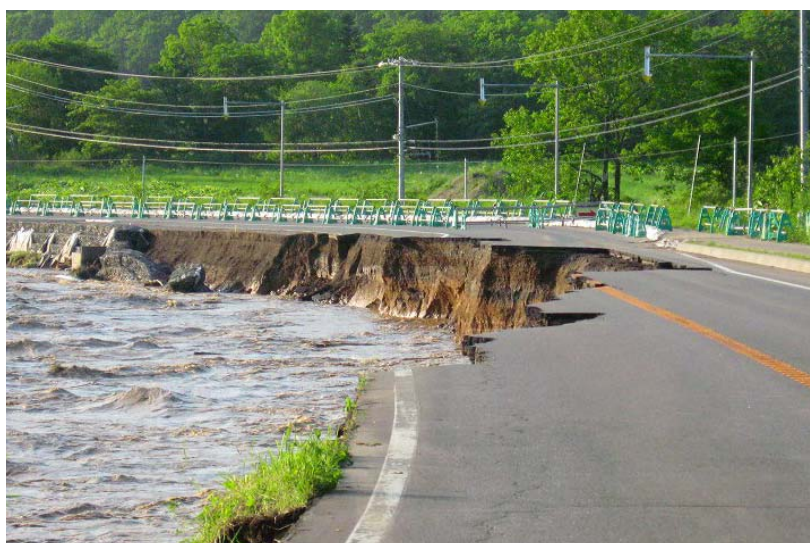
写真 3-14 河川洗掘による崩壊例（白糠町）
