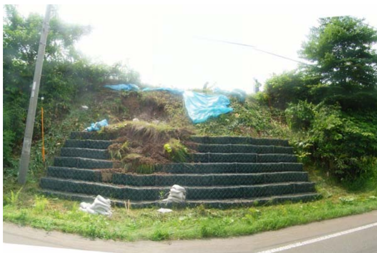
写真 3-8 地表面水の流入による崩壊例（芦別市）
