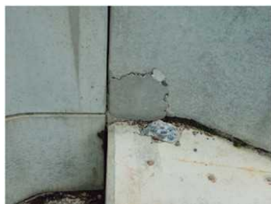
写真-9 茂庭沢親杭パネル壁被害状況
