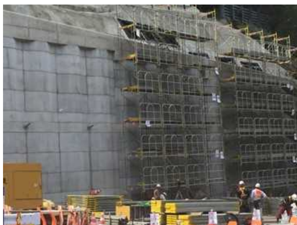
写真-6 国道での雪崩防止柵として採用された事例
