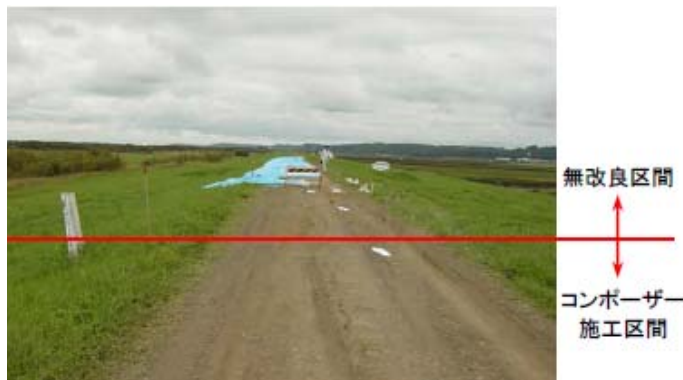
写真-20 地震後の被害状況（十勝川築堤） 2)
