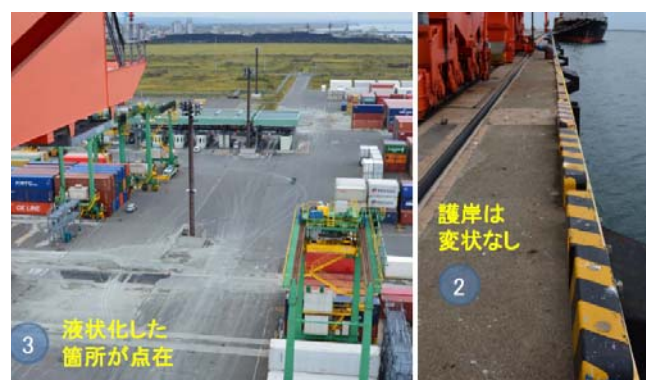
写真-22 地震後の被害状況（苫小牧東港） 3)
