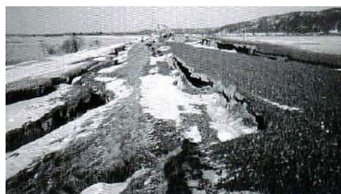
写真-12 釧路沖地震（釧路川遊水地築堤）
