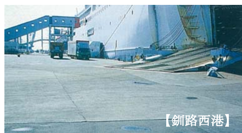
写真-10 北海道東方沖地震（対策後） 1)
