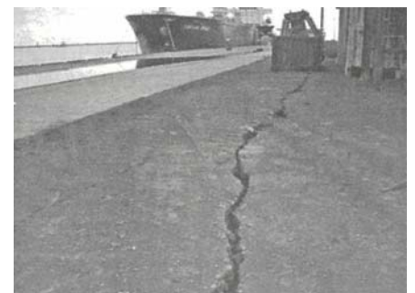
写真-4 十勝港（無対策箇所） 2)
