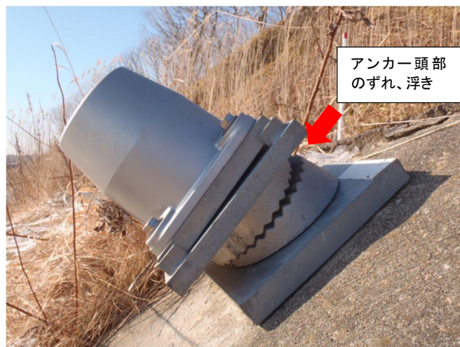
写真-1 凍上によるグラウンドアンカー頭部の損傷
