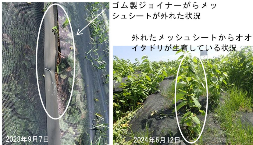
写真-2 ゴム製ジョイナーの状況
