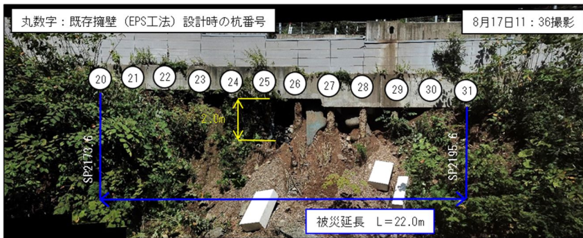
図-3 被災の状況（路面陥没部）
