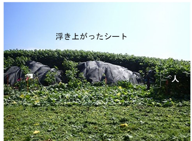
写真-3 ずれ留めが少ない場合のメッシュシートの状態
