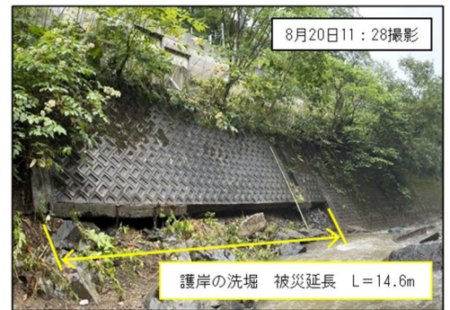
図-4 被災の状況（護岸部）
