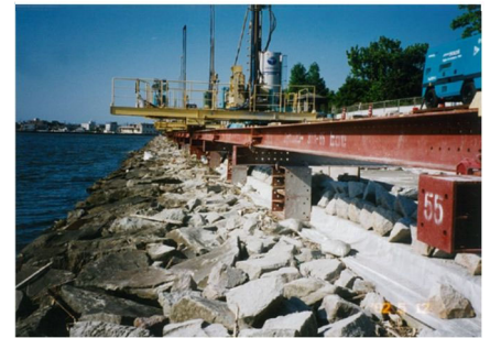
写真-1 被災した堤防部捨石層と軽量小型単相式高圧噴射工法の適用例
